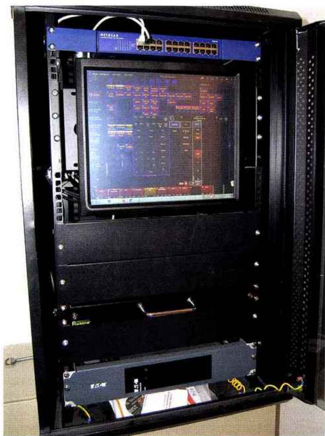
La baie de contrôle avec la MPC Martin, l'accès à distance et l'onduleur.
