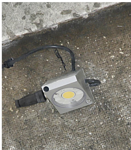
Luminaire WILSON-DOWNLIGHT développé spécialement pour ce projet
